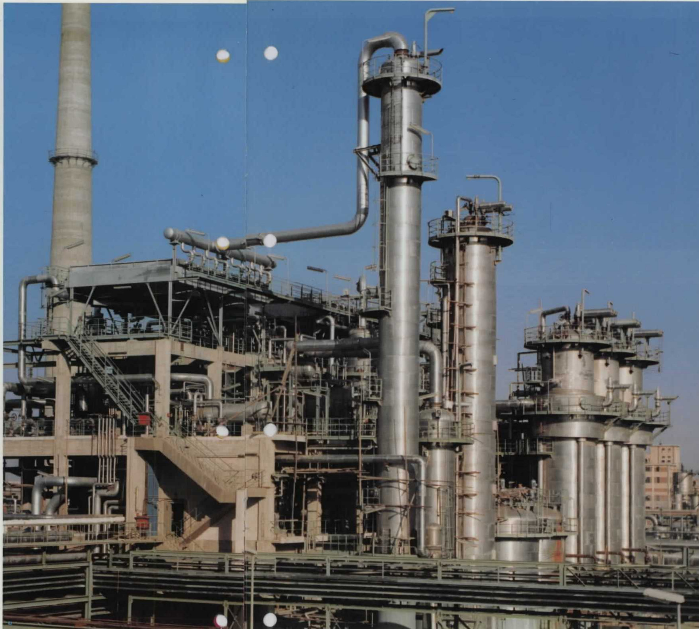
③ Anlage zur Erzeugung von Dimethylterephthalate (DMT) ③ Plant for the production of dimethylterephthalate (DMT) ③ Installation pour la production de diméthyl-teréphthalate (DMT)
